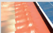
SYSTÈMES SOLAIRES (PV, Thermiques)
