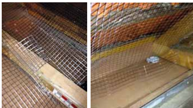
Figure 6 : Découpe et pliage du grillage en correspondance des entrains (gauche) et maintien de l'aération (droite)
