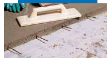
Chape Topcem avec fers de reprise
