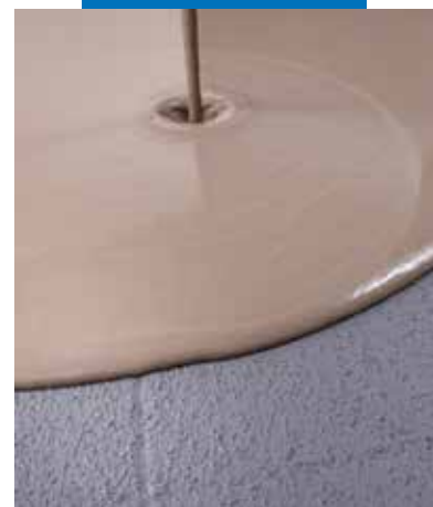
Application d'un lissage autonivelant sur Eco Prim Grip Plus sec et appliqué sur un sol ancien
