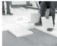
Mise en place des dallages (ici des dalles Castellane pack multiformat) sur lit de sable parfaitement de niveau.
