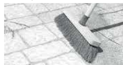
Veiller à bien faire pénétrer le sable dans les joints à l'aide d'un balai, puis compacter pour assurer une bonne pénétration du sable.
