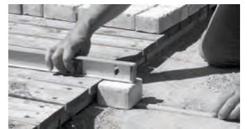
Vérifier la parfaite planéité du support lors de la pose des premiers pavés.
