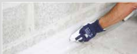
b- Placer Vélaphone® bandes de relevés le long des murs, des traversées de plancher et des huisseries, puis le film PE 150 µm ou la sous-couche acoustique mince Vélaphone® . Cette étape n'est pas nécessaire lorsque le béton léger est utilisé pour réaliser un ravaillage / remplissage léger.
